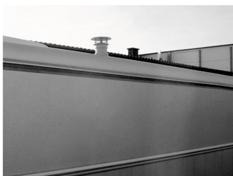
Afb. 84: Schoorsteen voor verbrandingsgassen van de gasverwarming
