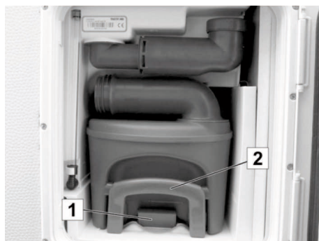
Fig. 154: Toilettank i tømmeskakten
