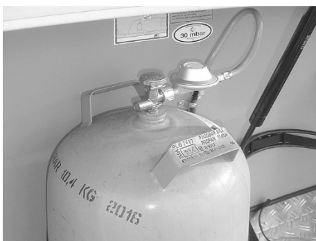
Fig. 107: Gasflaske med trykreduktionsventil
